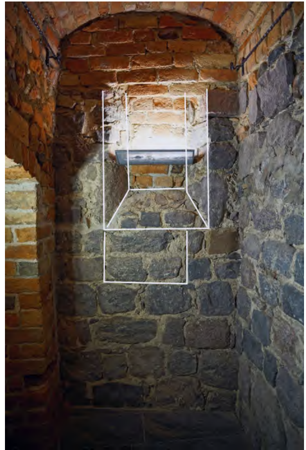
Abb. 7 Hauptstraße 9, Keller; Flur Raum 2, südliche Stirnwall mit Fenster. Weiß umrandet unten: aufgegebene (Fenster?) Nische, oben: ausgeführtes geschrägtes Fenster. 2023 (Foto: J. Müller).
