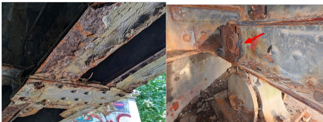
Abb. 3 und 4: Schadensbeispiele fortgeschrittener Korrosion am Tragwerk
