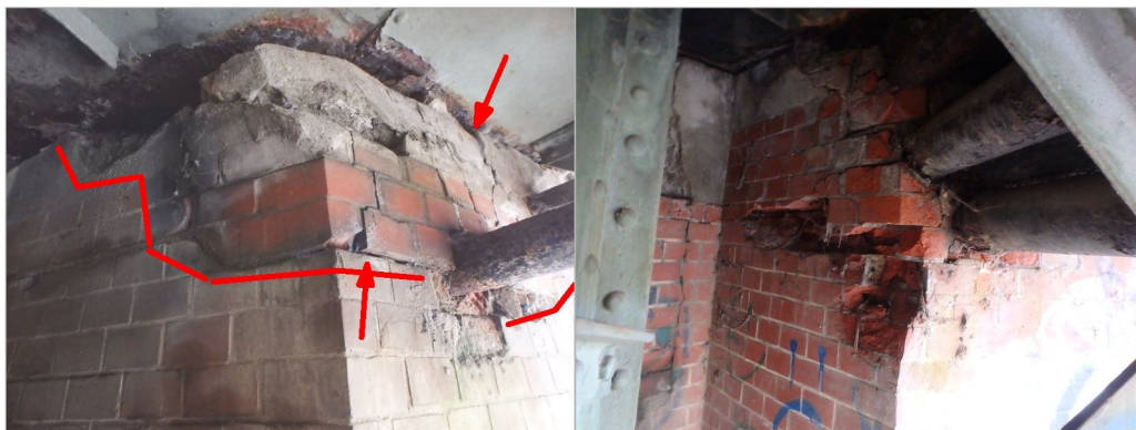
Abb. 5 und 6: Schadensbeispiele Verblendmauerwerk Widerlager
