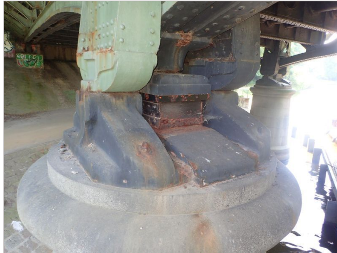
Abb. 7: Korrosionsschäden am Lager
