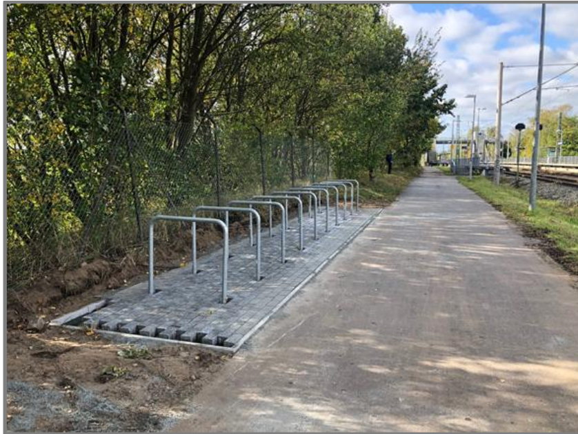
Abb.: Bike+Ride-Anlage am Bahnhofsteppunkt Lübeck-Dänischburg IKEA
