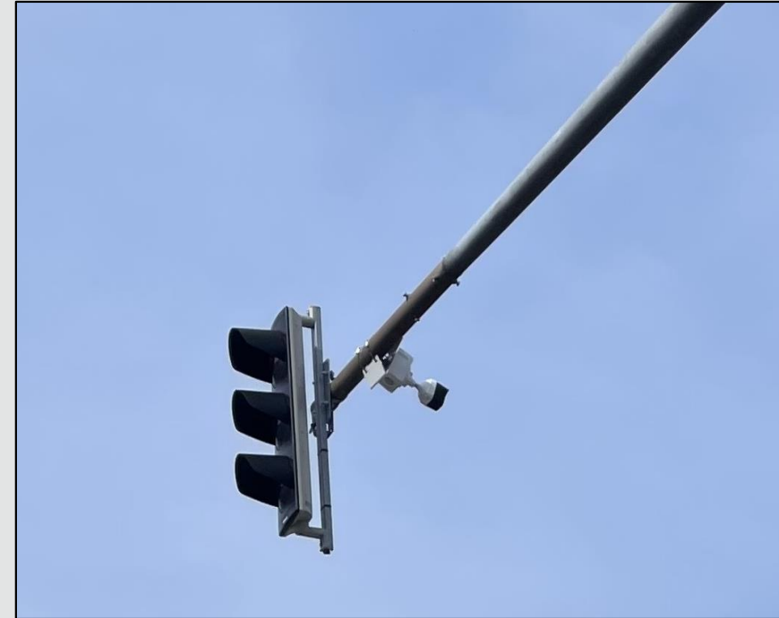
Sensor des Verkehrserfassungssystems
