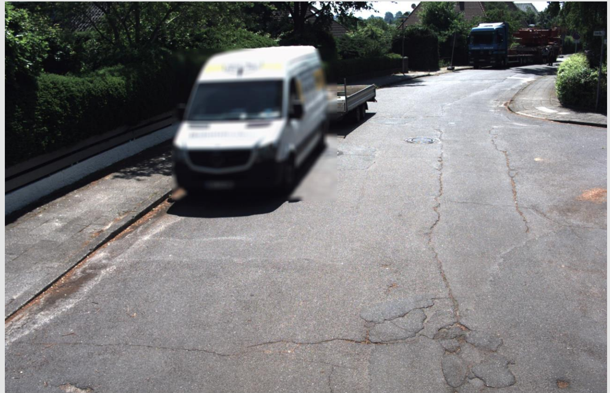
Straße: Grüner Weg, Abschnitt: 1573846 - 1573843, Station: 90, Lage: R, FS: 1
