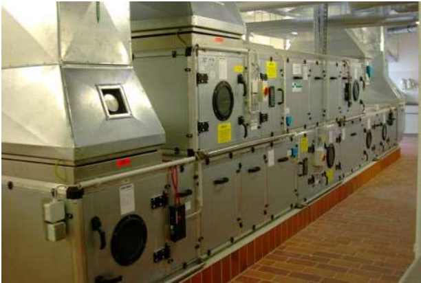
Abb. 4: Raumluftechnische Anlage eines Krankenhauses
