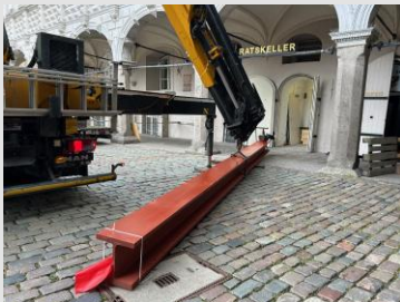
Bild 12 | Stahlprofil HEM300, Gewicht pro lfdm: 250 kg, Teil des Abfängerüstes im Rathaus
