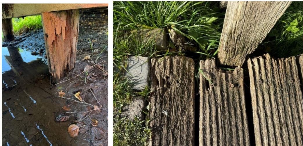
Abb. 3: Schadensbilder (Quelle: HL, 5.660)
