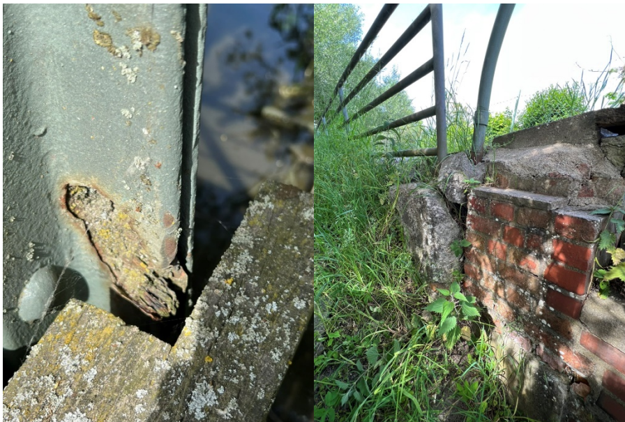
Abb. 3: Schadensbilder (Quelle: HL, 5.660)
