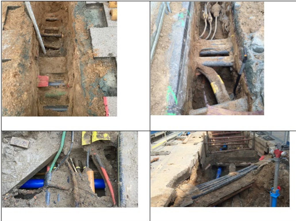
Abbildung 46: Verlegesituation in den Innenstadtstraßen, Beispiele aus Mengstraße, Breite Straße und Fünfhausen. Quelle: Stadtwerke Lübeck
