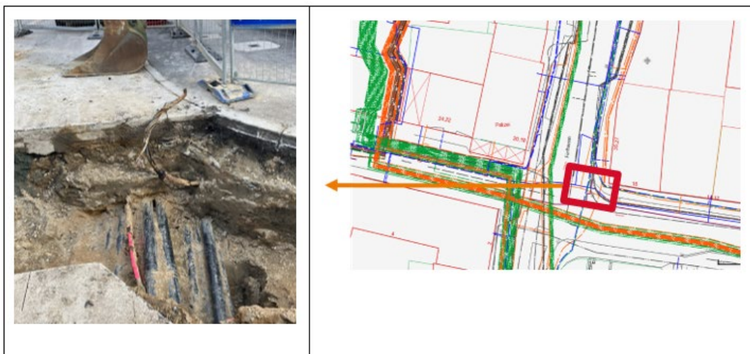
Abbildung 47: Verlegesituation in der Straße Fünfhausen: Realität und Kartendarstellung auf Basis vorhandener Daten. Quelle: Stadtwerke Lübeck
