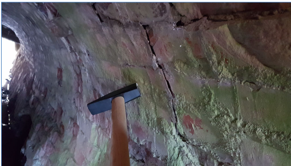
Abb. Ansicht gerissenes Mauerwerk unter Verkehrsweg
