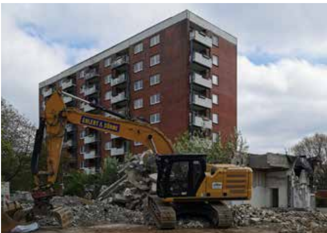
Abb. 107: Ordnungsmaßnahme ehem. Penny-Markt
