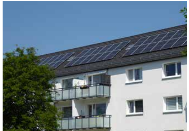
Abb. 118: Photovoltaik-Anlage im Geschosswohnungsbau
