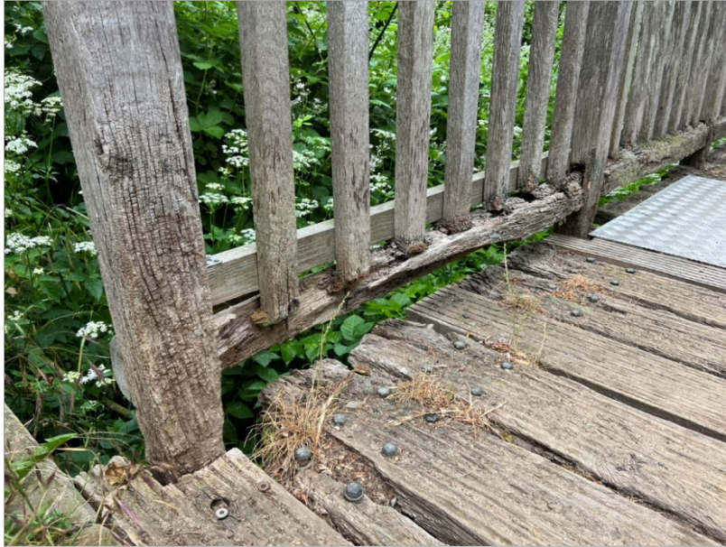
Abb. 3: Schadensbild Geländer (Quelle: HL, 5.660)
