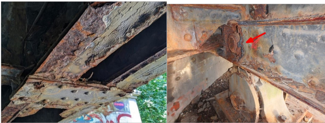
Abb. 3 und 4: Schadensbeispiele fortgeschrittener Korrosion am Tragwerk
