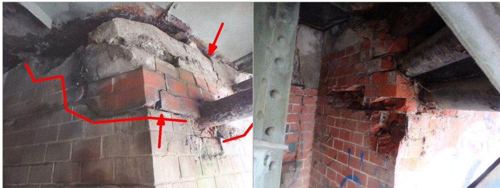
Abb. 5 und 6: Schadensbeispiele Verblendmauerwerk Widerlager
