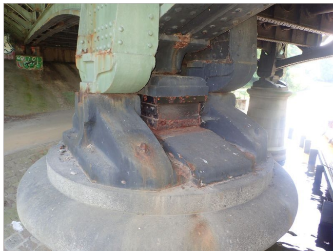
Abb. 7: Korrosionsschäden am Lager
