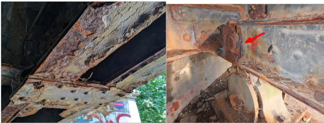
Abb. 3 und 4: Schadensbeispiele fortgeschrittener Korrosion am Tragwerk
