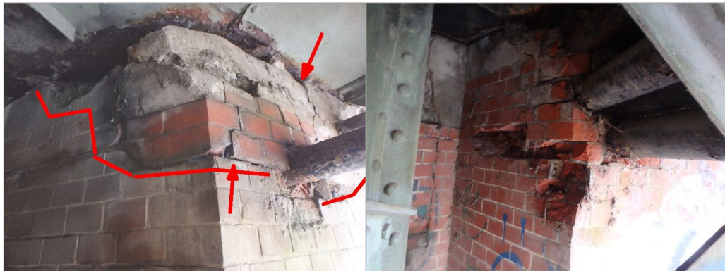
Abb. 5 und 6: Schadensbeispiele Verblendmauerwerk Widerlager
