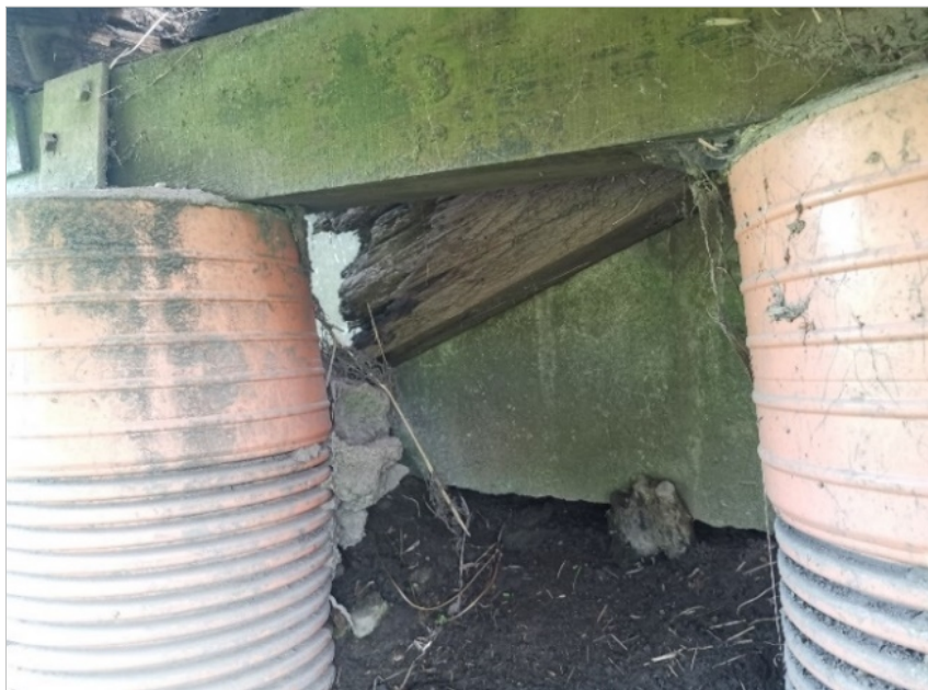
Abb. 3: Schadensbild Tragkonstruktion (Quelle: HL, 5.660)
