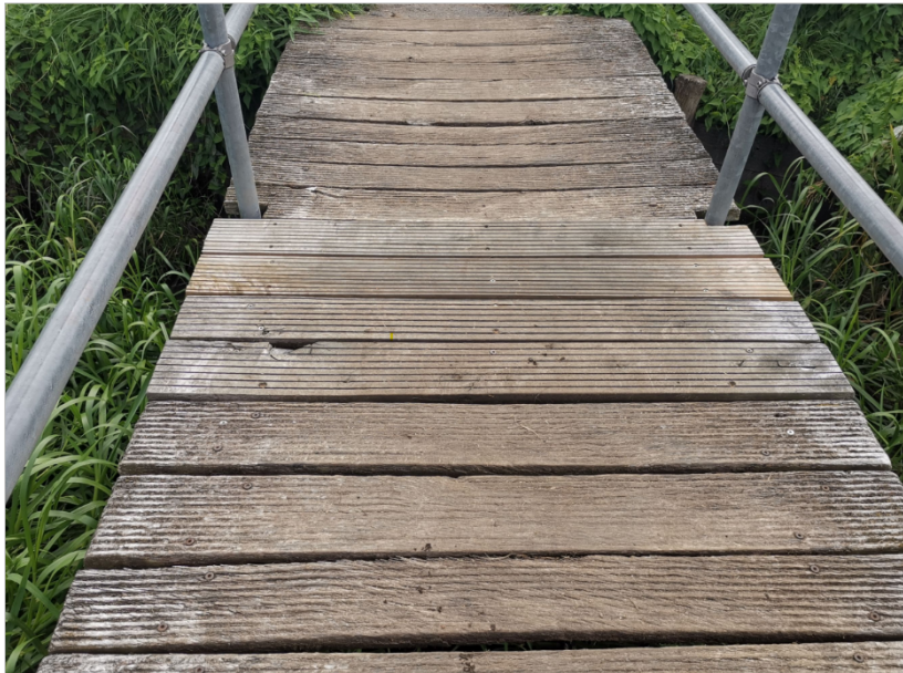
Abb. 2: Schadensbild Bohlenbelag (Quelle: HL, 5.660)
