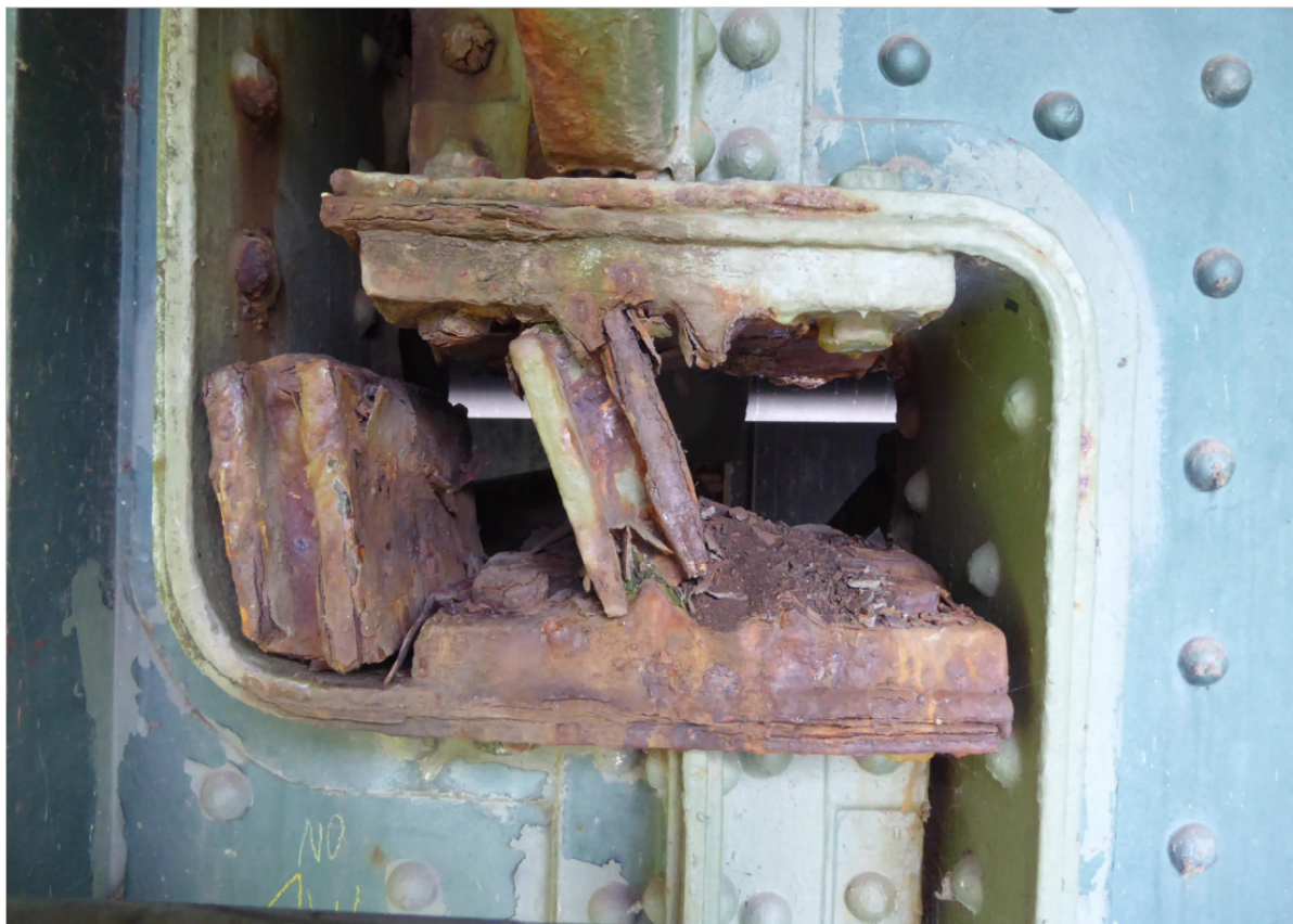
Abb. 4: Schädigung am Stelzenlager (Quelle: HL, 5.660)
