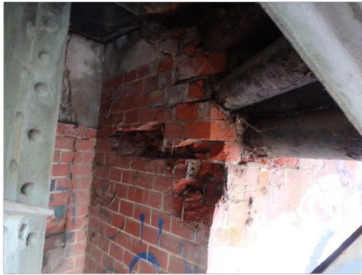
Abb.: Lagersockel gerissen
