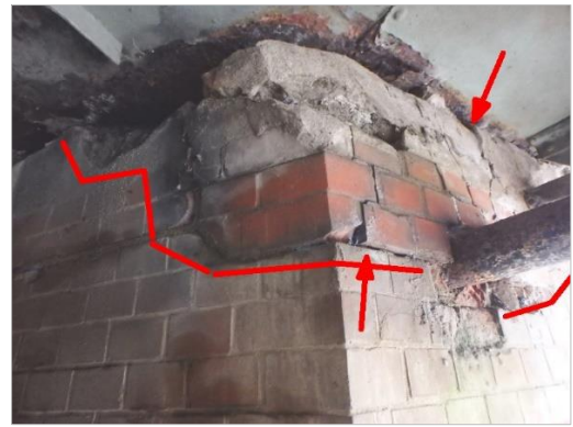
Abb.: Widerlagerwand – Abplatzungen Verblendmauerwerk
