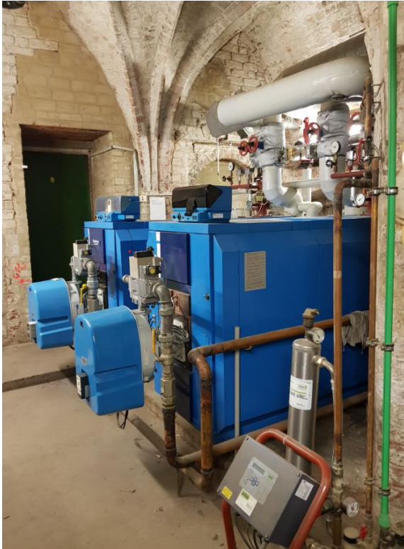
Heizungstechnik: bestehende Wärmeerzeugung im historischen Kellerraum
