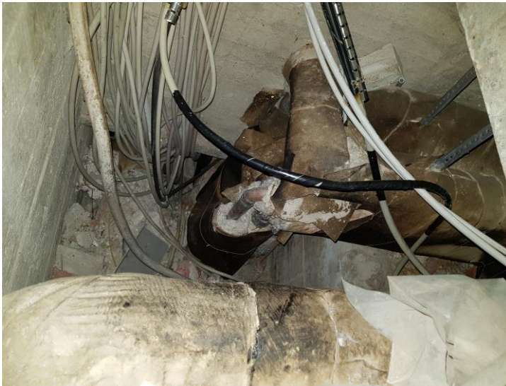
Gebäudetechnik: Installationstunnel mit unzureichender Schottung
