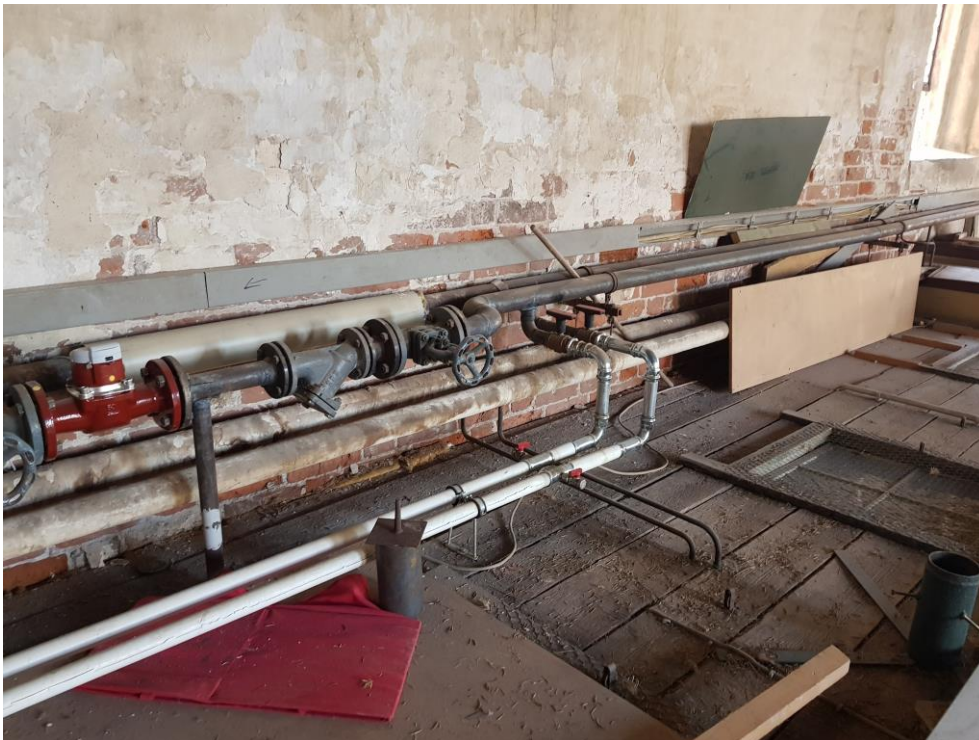
Heizung / Sanitär: Historische Versorgungsleitungen oberhalb der Kabäuschen
