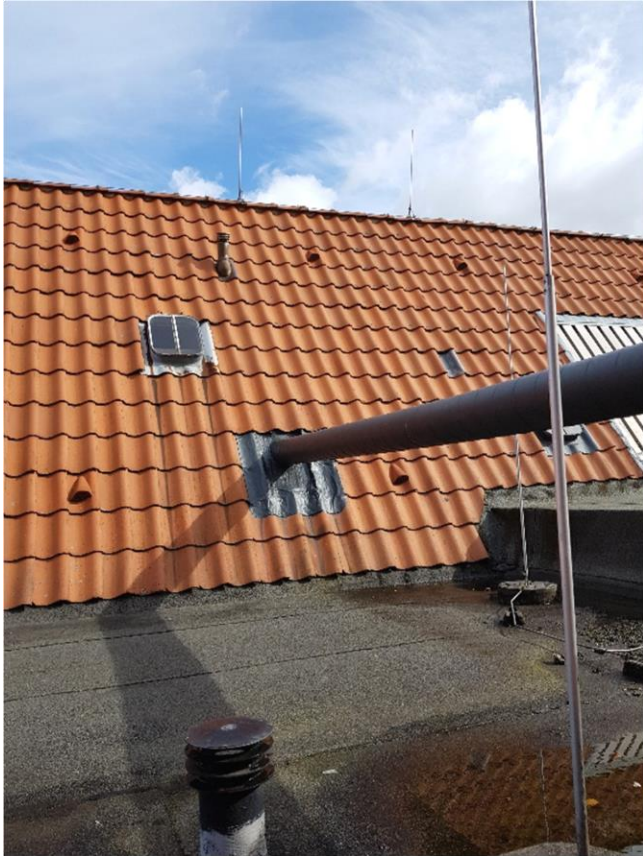
Lüftungsanlage: Lüftungskanäle im Außenbereich
