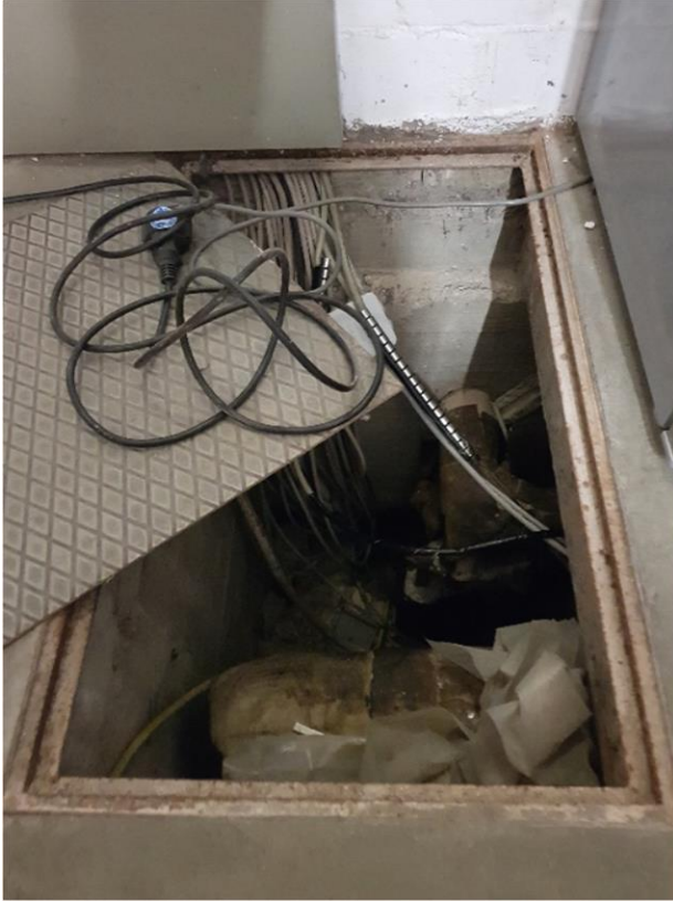
Gebäudetechnik: Installationstunnel mit unzureichender Schottung
