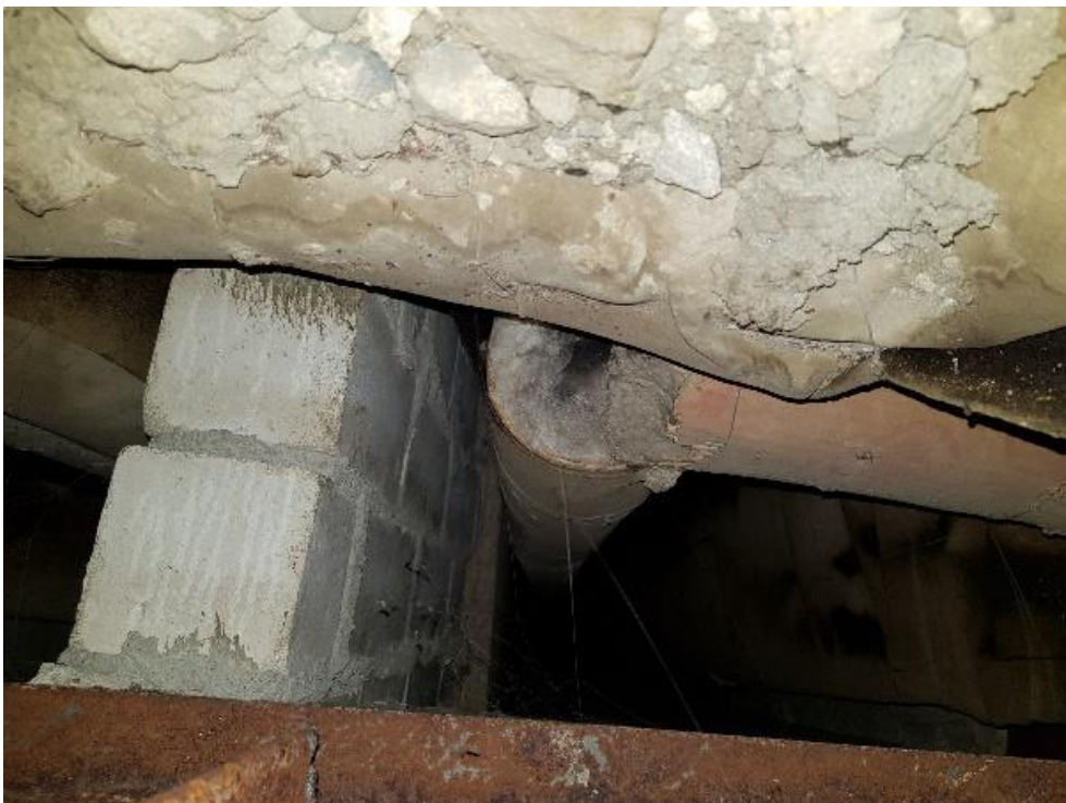
Heizung: Historische Wärmeverteilungsleitungen, fehlende Schottungen
