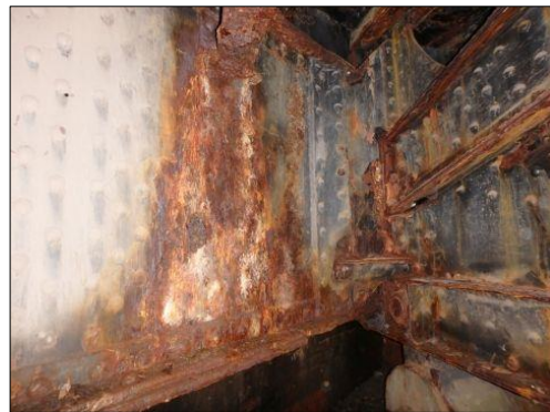
Abb.: Korrosionsschäden an einem Knotenpunkt des Überbaus mit Querschnittsschwächung
