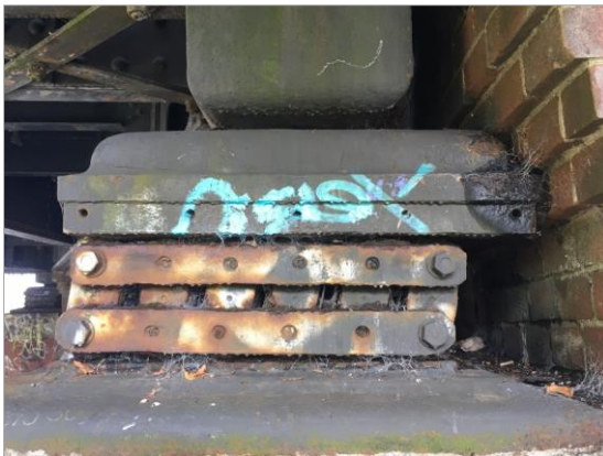
Abb.: Korrosion am Lager, Lagerweg behindert
