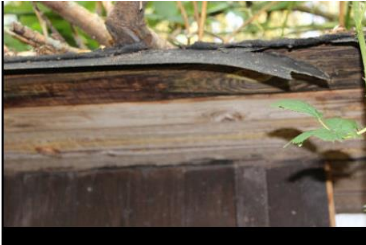
Gartenlaube 2: Nur noch Holz und einige Reste Dachpappe.
