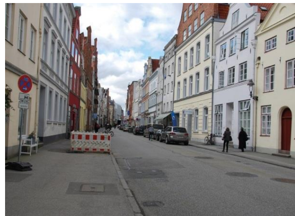
Abb. 39: Wahnstraße - Hoher Instandsetzungsbedarf
