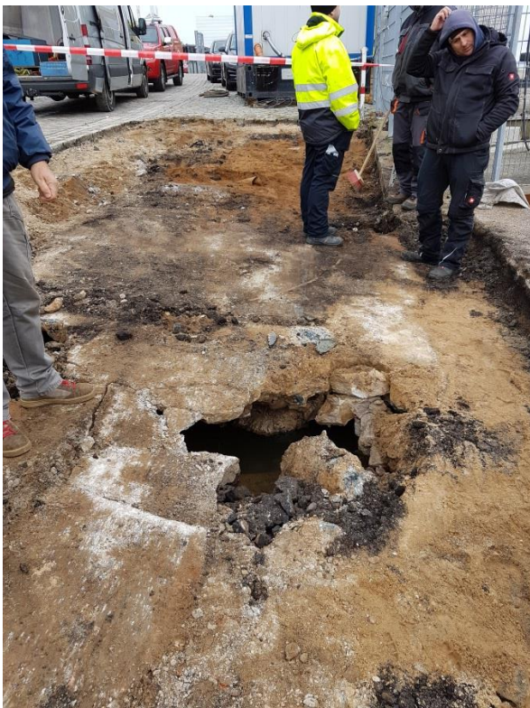
Hohlräume zwischen Straße und Kaimauer
