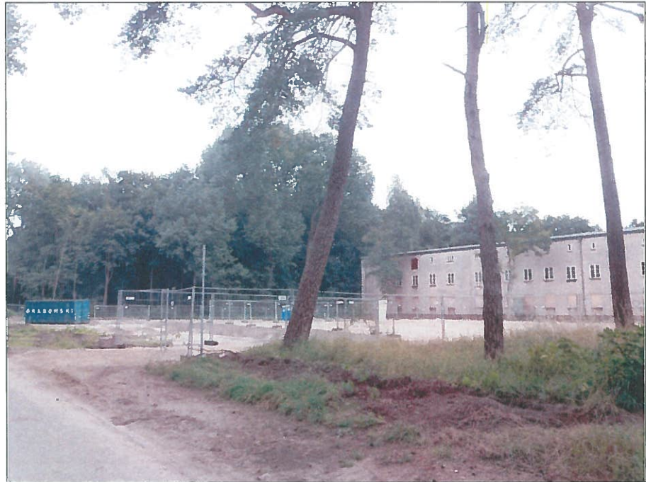
Abb. 1: Bei der links im Bild befindlichen Kiefer wurde bei Rodungsarbeiten eine Wurzel freigelegt.
