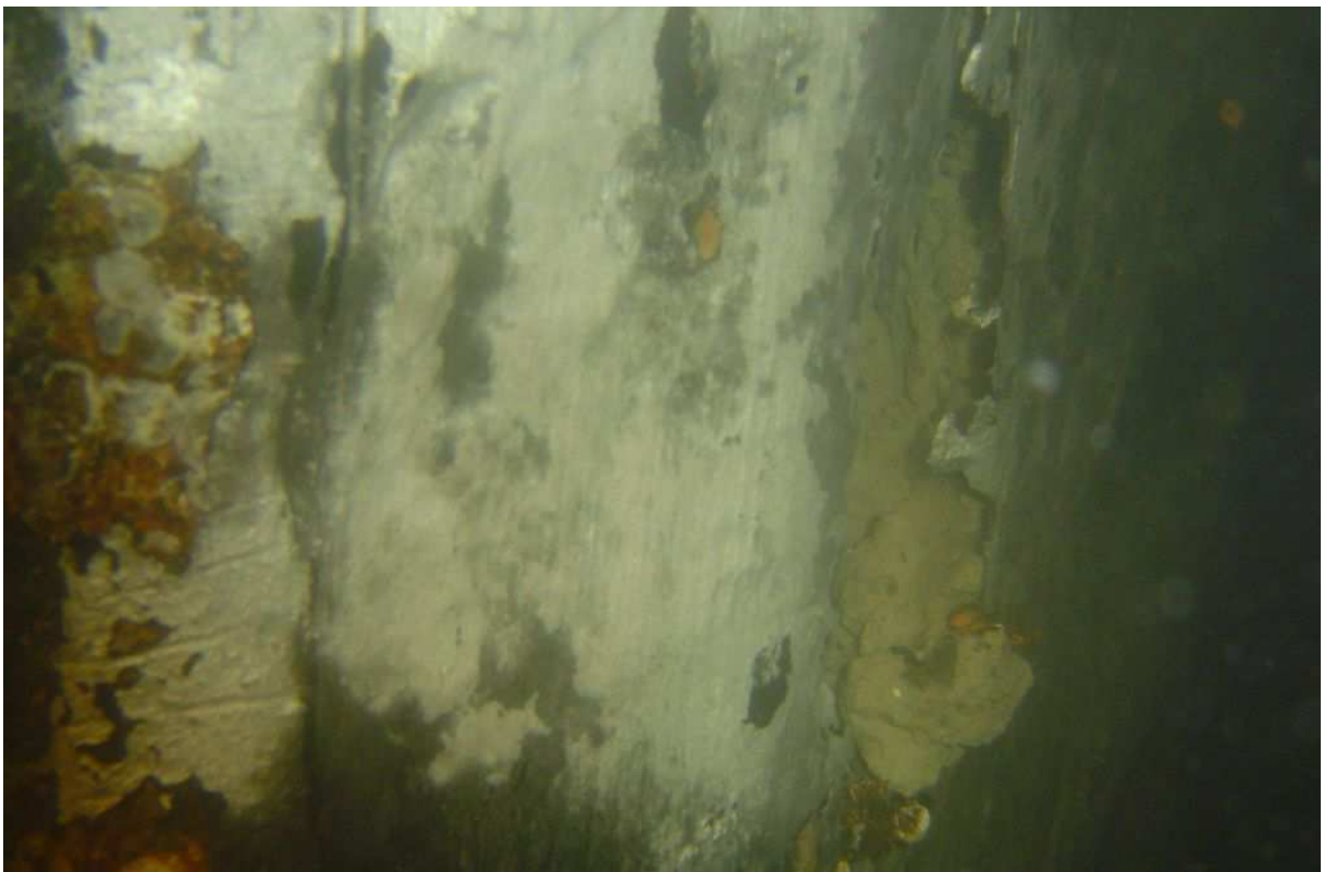
Fortgeschrittene Korrosion und Löcher
