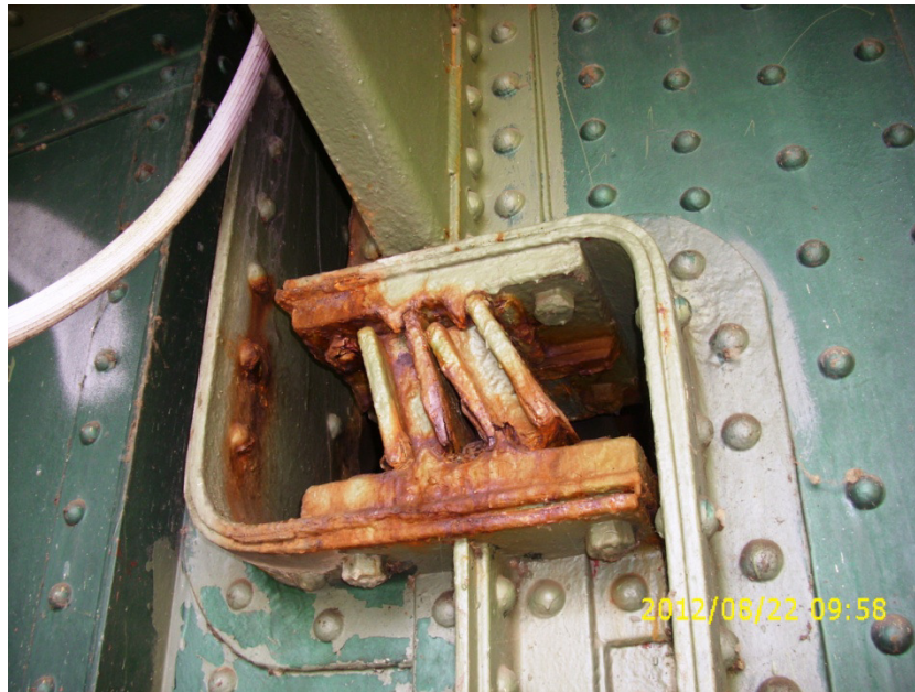
Abb. 10 Schiefstellung der Lager im Gerbergelenk
