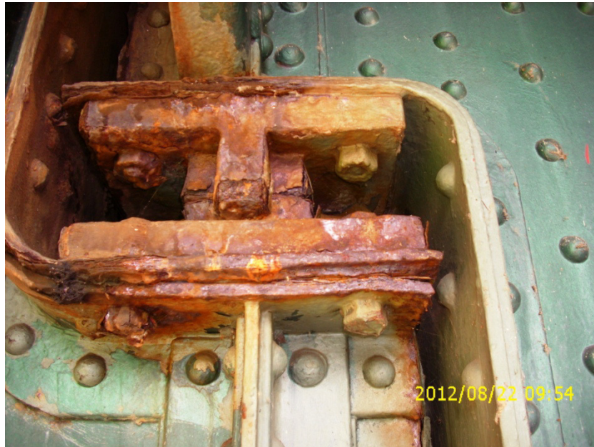
Abb. 8 Korrosion an Lagern der Gerbergelenke
