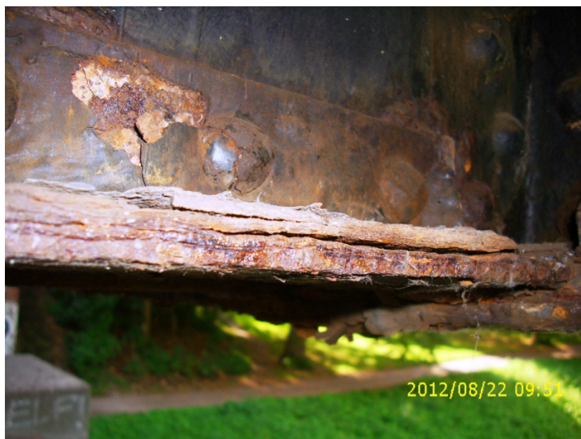
Abb. 6 Schäden an tragender Konstruktion infolge Korrosion
