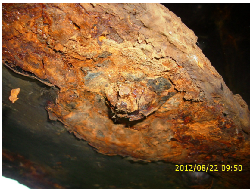
Abb. 7 Teilweise weggerostete Nietköpfe
