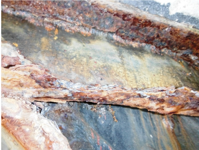
Abb. 7 Schäden an tragender Konstruktion infolge Korrosion
