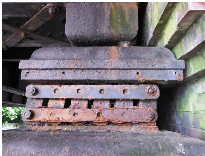
Abb. 10 Lagerverschiebung am Widerlager West
