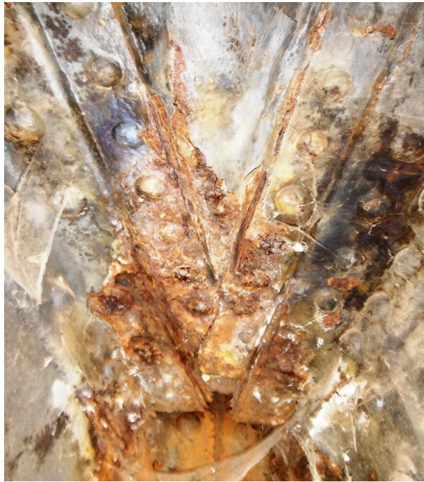
Abb. 9 Teilweise weggerostete Nietköpfe
