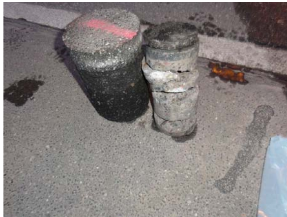
Possehlbrücke - AKR-geschädigter Beton
