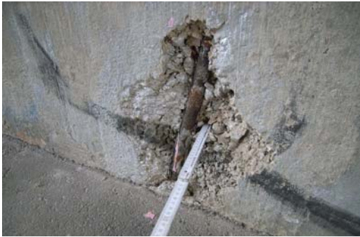
Widerlager – freiliegende Bewehrung
