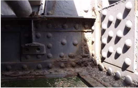
Fortgeschrittener Schaden am Untergurt
