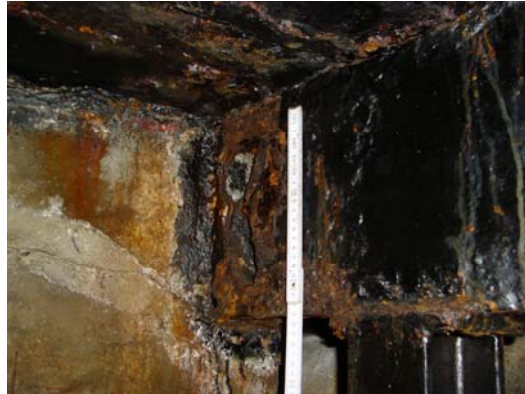
Korrosion Stahlträger Kammer
