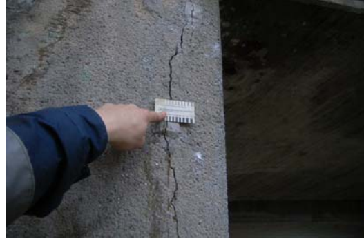
Längsriss am Widerlager
