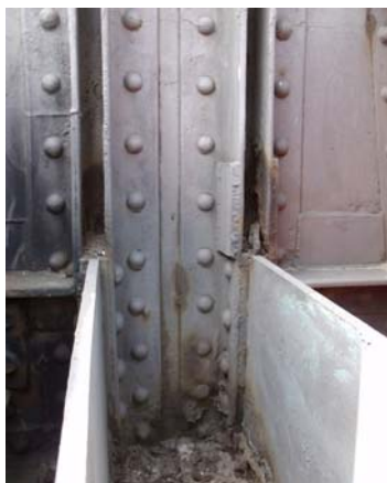
Hafendrehbrücke – fehlerhafter konstruktiver Korrosionsschutz
