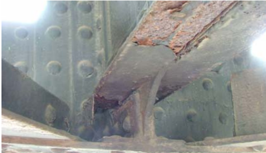
Beschichtung abgeplatzt (Untergrund verrostet)
