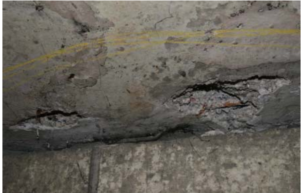
Kiesnest mit freiliegender Bewehrung
