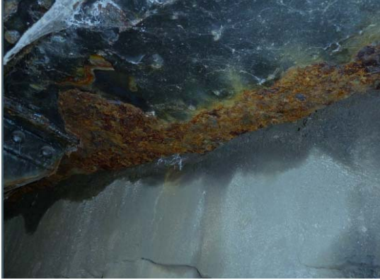
Korrosion Unterseite Deckblech
