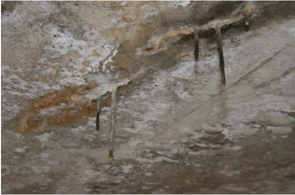
Stalaktitenbildung infolge Durchfeuchtungen
