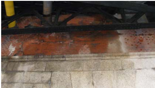
Durchfeuchtungen Widerlager Vorstadtseite
