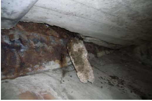
Kragarm – Kante abgeplatzt
