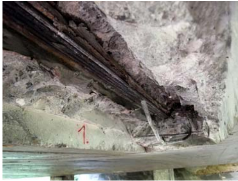
Straßenbrücke Wesloe - Entnahme von Spannlitzen bei Verdacht auf SpRK
